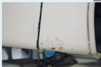
Bisweilen löchrig: der Bereich unten hinter der Türe.
